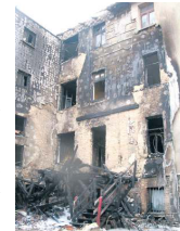
Die Westwand des Gebäudes hat besonders gelitten. FOTO: DWOREK
